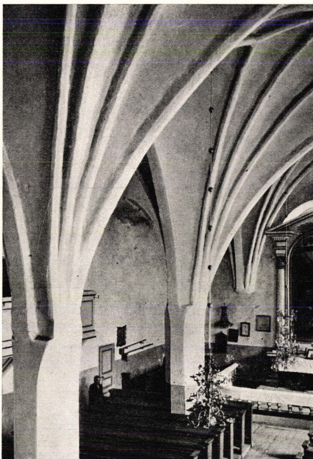
Bild 57. Pojo. Ojämnhet i nordmuren vid sakristian, föranledd av de nya valven.
